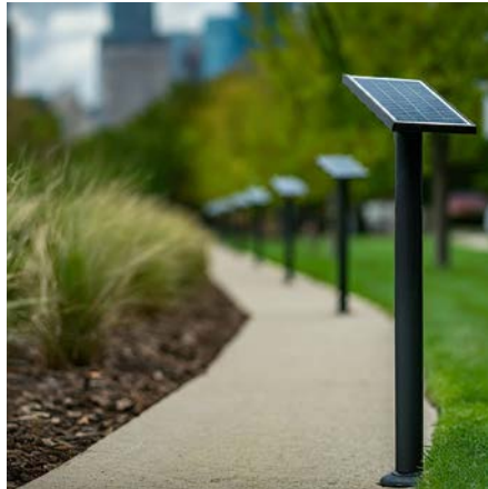
حيثما أمكن، ينبغي استخدام الطاقة الشمسية لتوليد الإضاءة. (موجه إرشادي ٧,١١,١٣)
